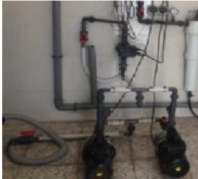
Figure 8 : Deux pompes de la boucle de distribution
