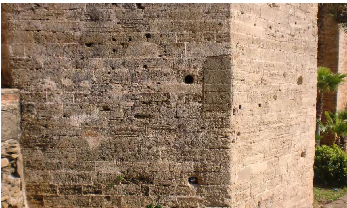
Figure 1.8 – Désagrégation sableuse sur un mur en calcarénite (site Oudaya).
