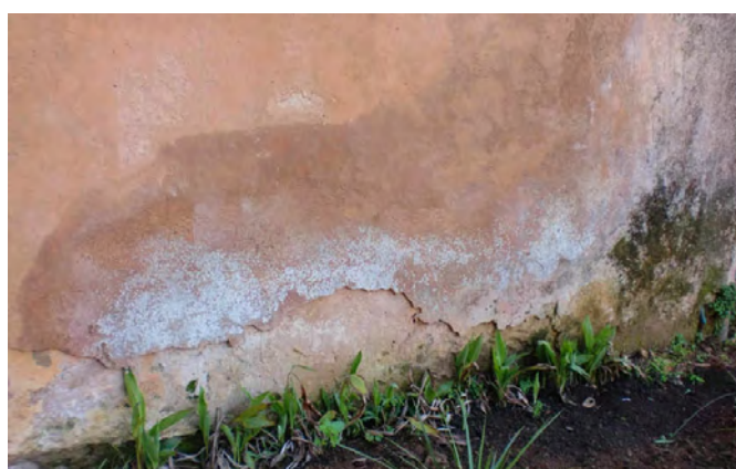
(d) efflorescence croûte
