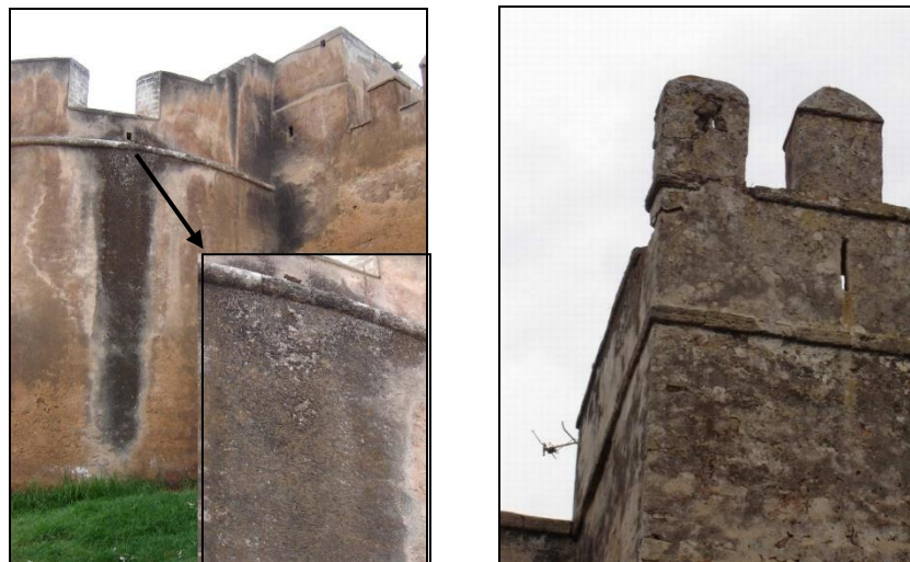
Ph 4.11 Prolifération des lichens au niveau des descentes de l'eau de pluie et dans les parties supérieures de l'édifice mouillées.
