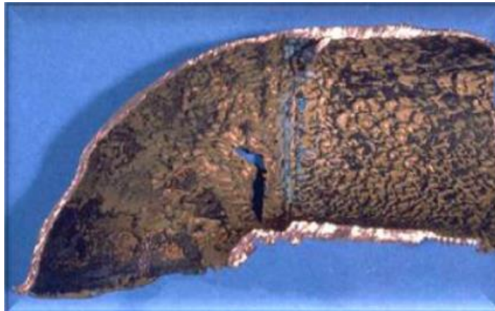
-Figure 86 : La corrosion caverneuse
