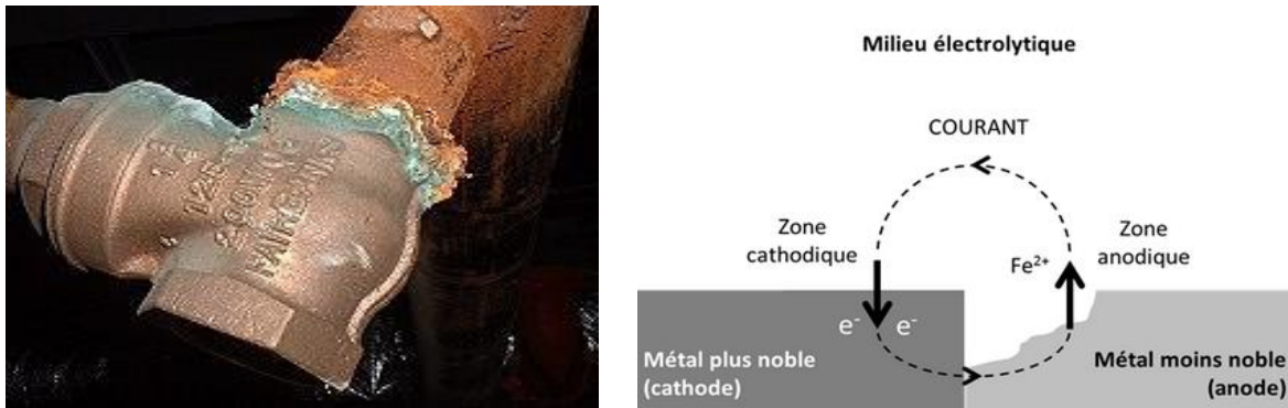
Figure I.6. : Corrosion bimétallique résultant d'un assemblage de deux métaux différents : robinet en cuivre et conduite en acier galvanisé.
