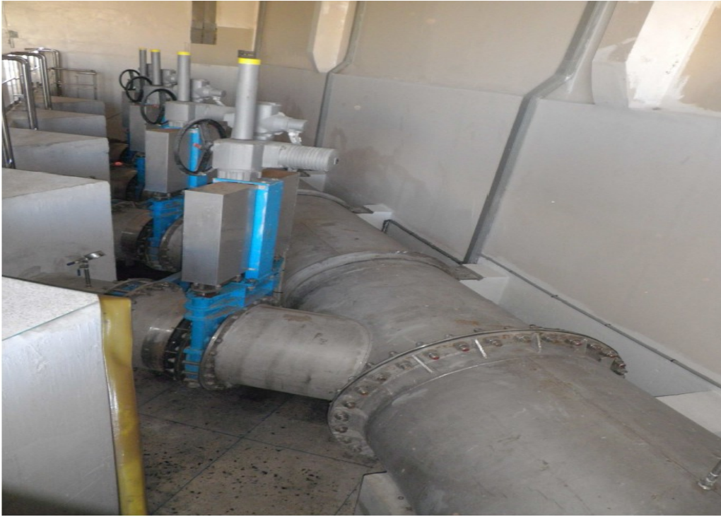
Fig. V.14. Vue depuis la station de prétraitement de la partie terrestre de l'émissaire de la baie de Tanger
