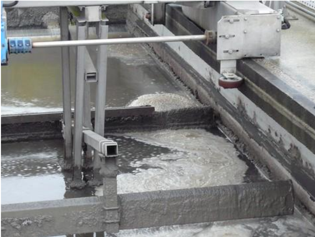
Figure I-1 : Photo d'un déshuileur utilisé dans l'épuration des eaux usées
