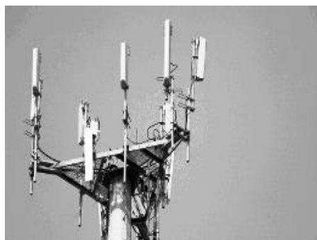
FIGURE 1.5 – Une station de base pour la communication civile, composée de plusieurs antennes.
