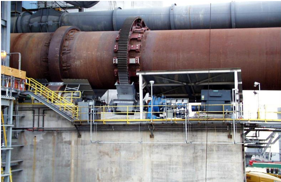
Figure 4.46 Situation du réducteur au niveau du four.
