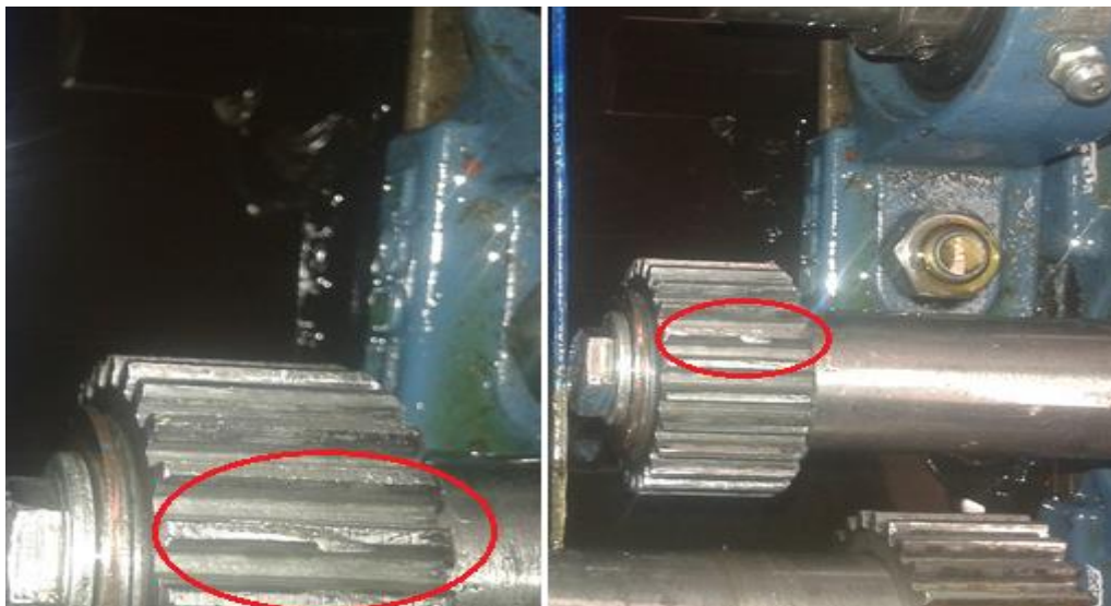
Figure 4.40 Pitting sur le pignon du premier étage.
