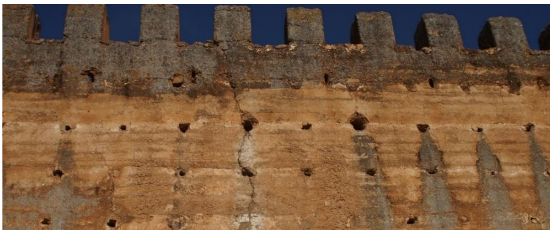
Photo 25 : aspect de dégradation biologique de la muraille sud Kasabah Ismailia (source auteur)
