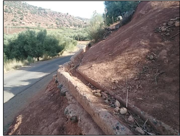
Figure 2-8: Seguia en béton abandonnée
