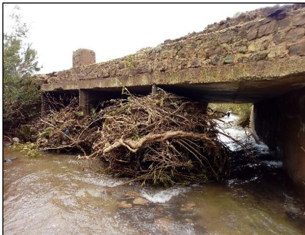
Figure 10-26 : Bloc d'embâcles végétaux (pont en aval du Kerrouchen)
