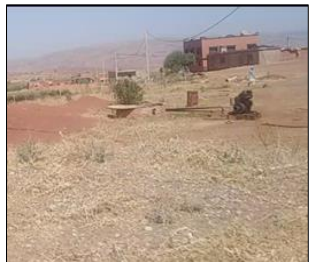
Figure 2-102 : Puit équipé d'une pompe verticale avec un moteur diesel
