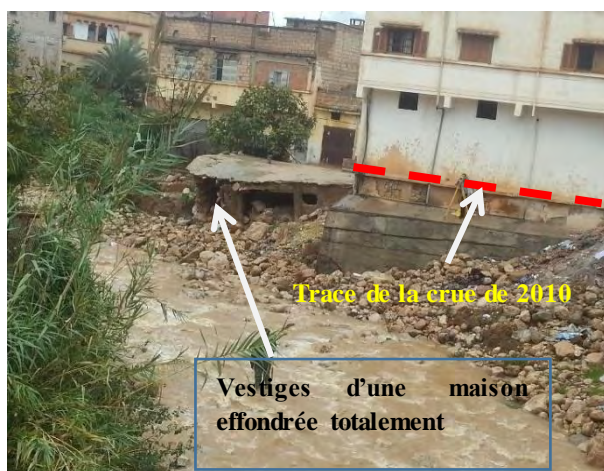
Dégâts et destruction des maisons par les crues de l'Oued Ikkour dans le quartier d'Ikkour (Zaouit Echeikh)
