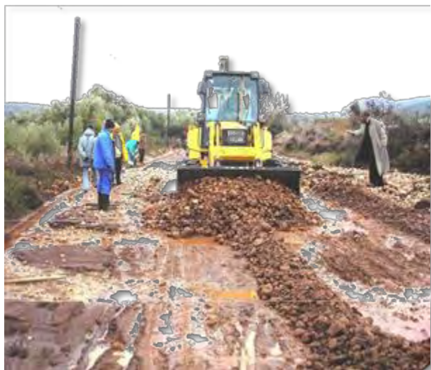
Sédiments déposés sur la route de Affela N'ifrane lors de la crue du janvier 2008.
