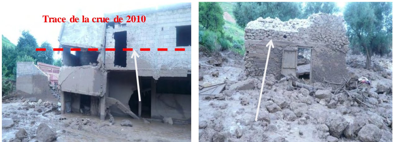
Planche photos 8.2 : Maisons détruites par les inondations dans le "dir" de "Beni Mellal".
