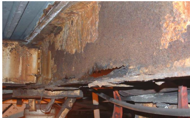
Figure 4: Perte en matière par corrosion le long de l'interface âme-aile d'une poutre en acier dans un assemblage boulonné. [4]
