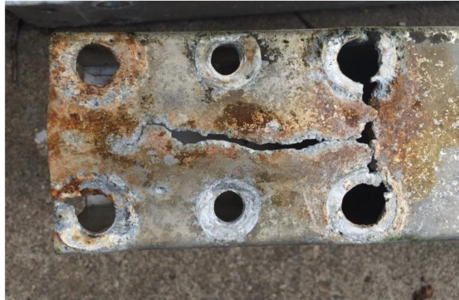
Figure 54: Dommages dû à la corrosion d'une platine d'extrémité.
