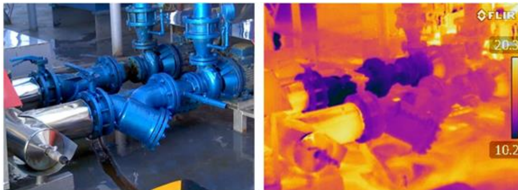
Figure IV. 7:images des pompes d'alimentation des installations prises par la caméra thermique.
