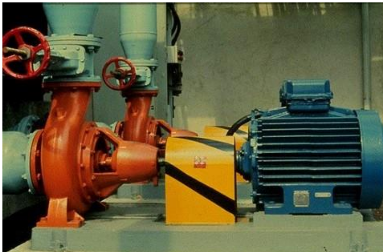
Figure 4. 1: Pompe centrifuge installée dans une zone de production OCP-Maroc.
