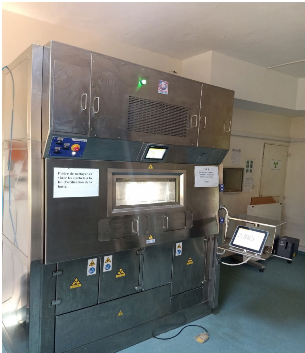
Figure 15 ; Enceinte blindée du laboratoire chaud
