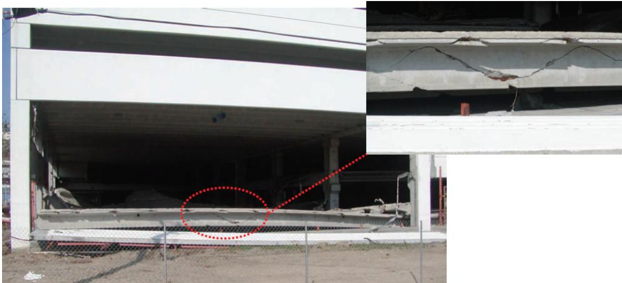
Figure 5.5 : Rupture par flexion négative d'un système de plancher en raison des forces de soulèvement ( Heintz and Mahoney, 2008 ).
