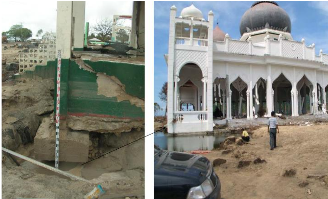
Figure 5.6 : Affouillements autour des fondations superficielles (Leonard et al., 2011).
