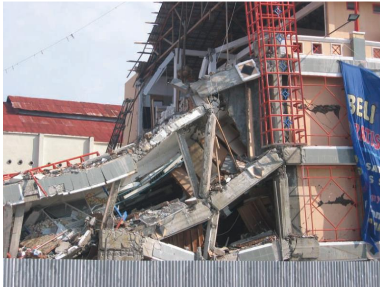
Figure 5.3 : Rupture de la connexion poteaux-poutres (Saatcioglu et al., 2005).
