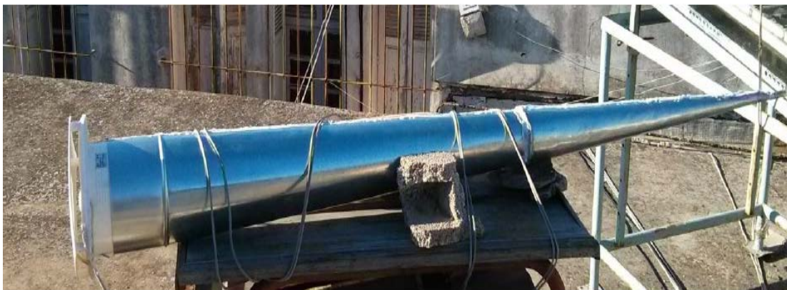
Figure II- 20: Système de ventilation
