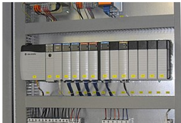
Figure 13: Armoire à base d'API
