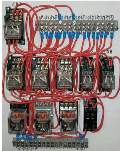
Figure 12 : Armoire à relais
